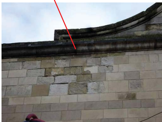
Detail vorstschade voorgevel
