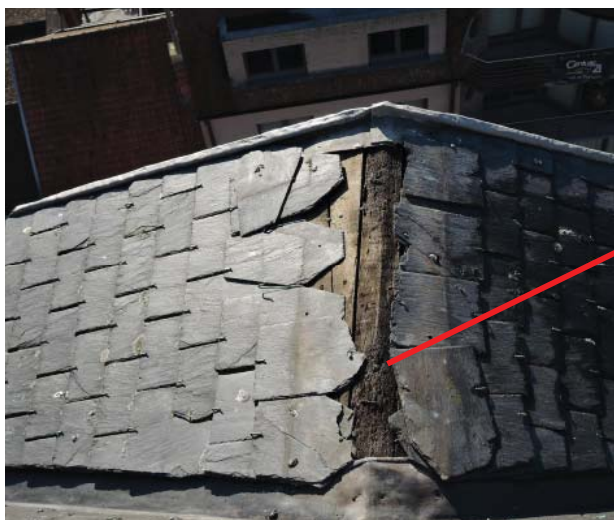
ontbrekend noklood en losliggende leien
