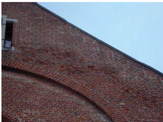
Dakvlakken 43/44, westelijke topgevel: uitgevallen voegwerk
