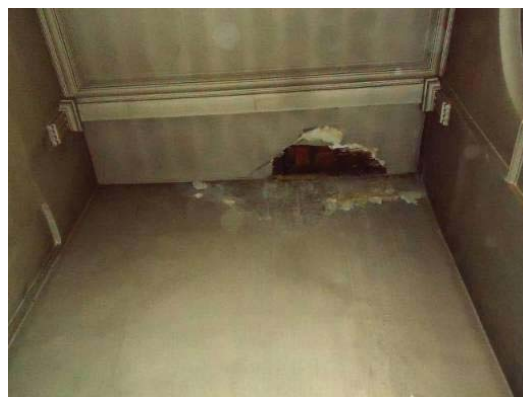
Detail schade aan plafond
