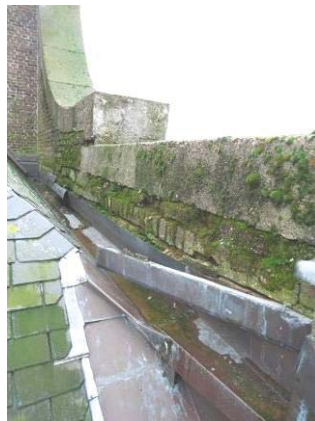
Loskomende aansluitingen en uitgebuikt metselwerk
