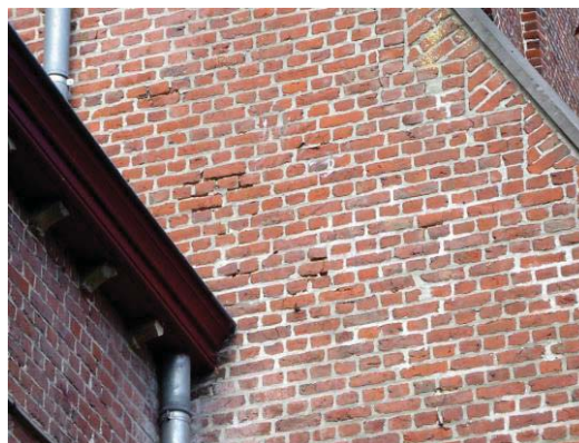
Dakvlak 27, zuidelijke topgevel: uitgevallen voegwerk
