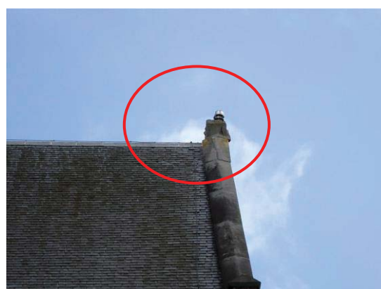
Dakvlakken 27/42: gebarsten schouw
